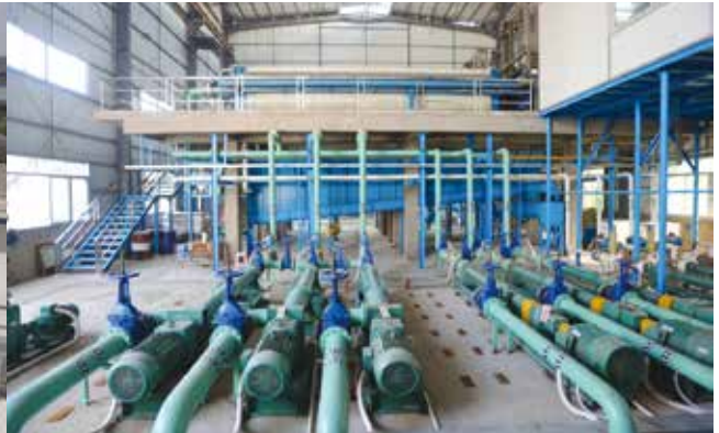
污泥压滤车间
